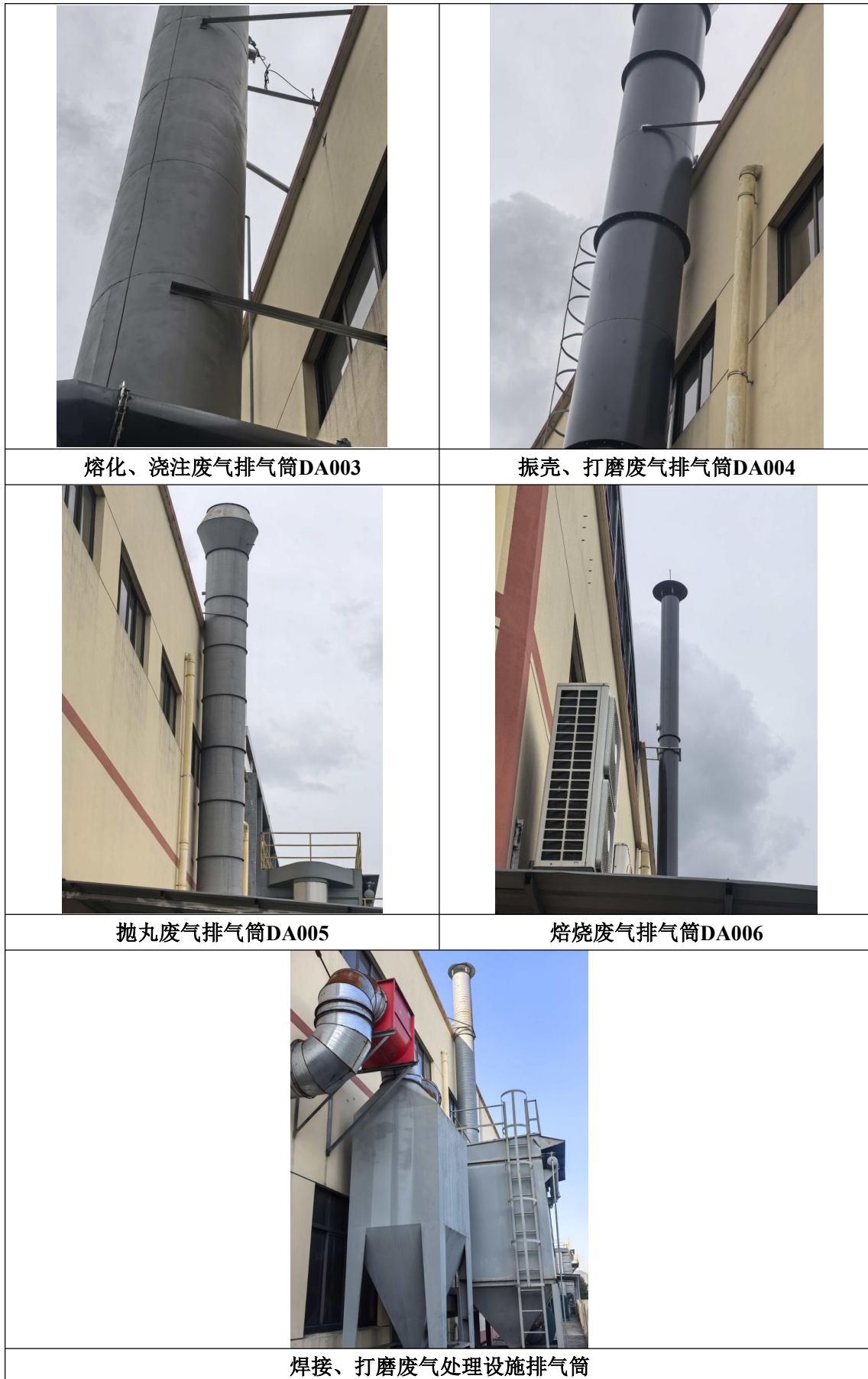
图4-2 废气处理设施照片
